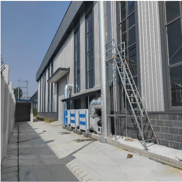
图 3-1 现场废气处理设施
