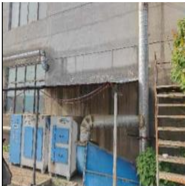
图 3-1 现场废气处理设施
