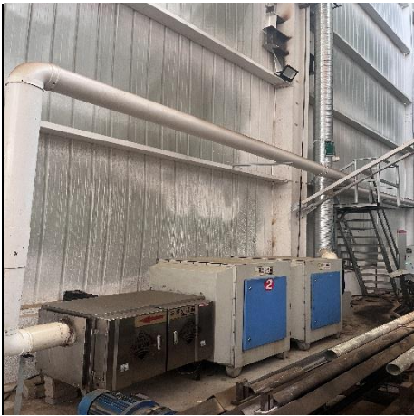
图 3-1 现场废气处理设施
