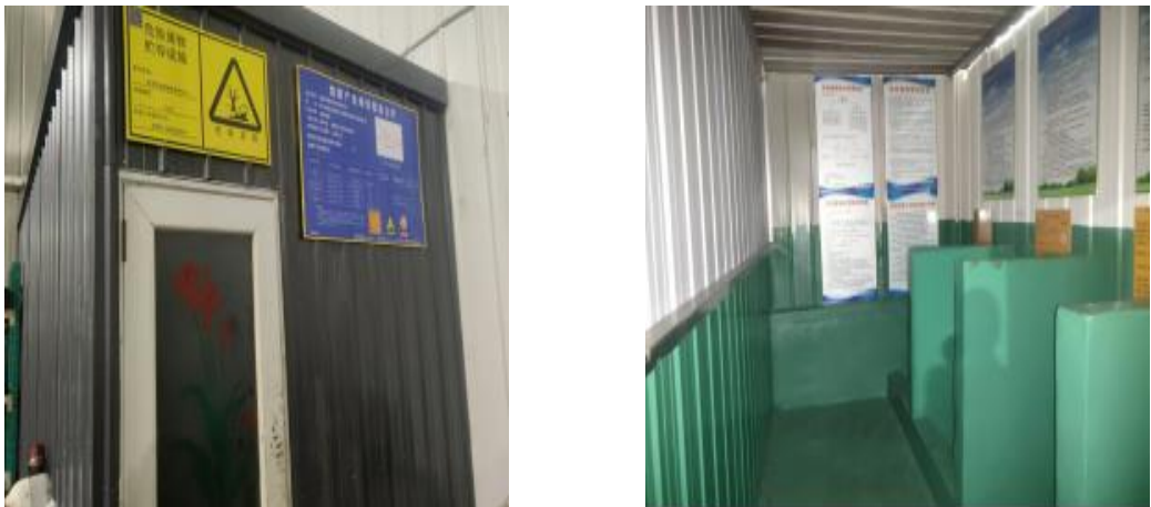
图 3-2 危废暂存间现状图
