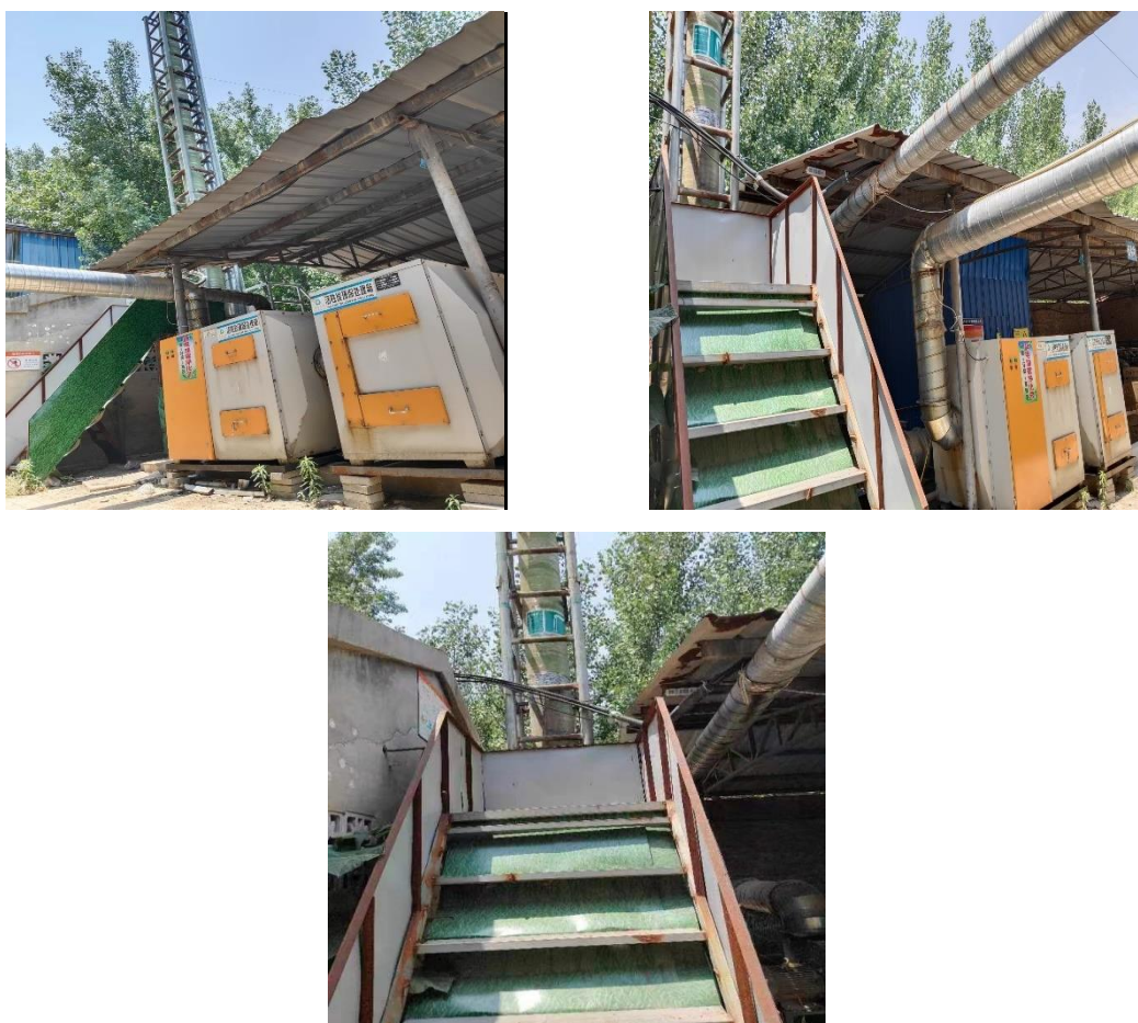
图 3-1 现场废气处理设施
