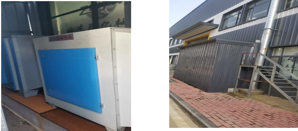
图 3-1 现场废气处理设施
