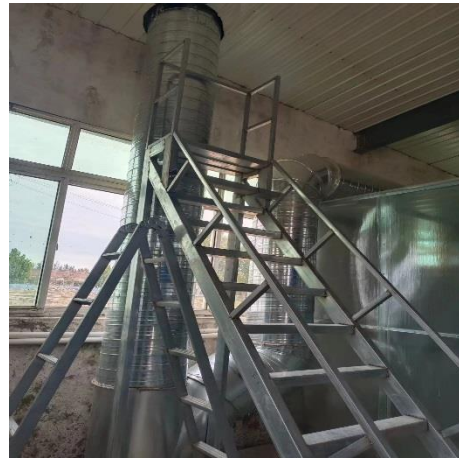
图 3-1 现场废气处理设施
